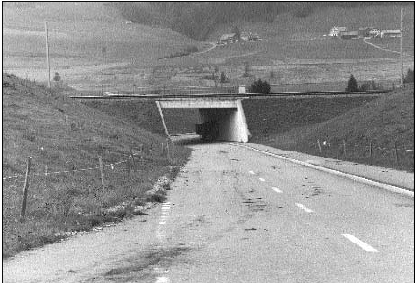
Vor 16 Jahren erbaut, nie gebraucht und jetzt ein Abbruchobjekt: Die Erschliessungsstrasse von der A8 zum einst geplanten Kasernenstandort besteht seit der Moorschutz-Initiative widerrechtlich.
